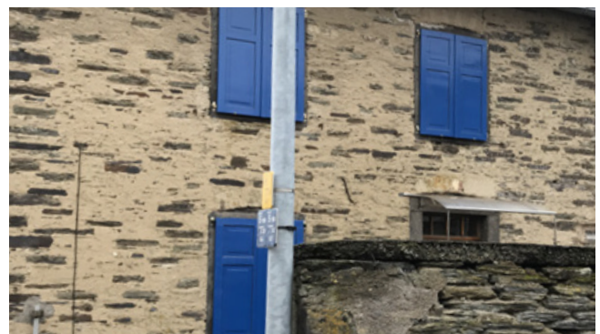
aufdringliche Farbgebung (Fensterrahmen, Klappläden)
