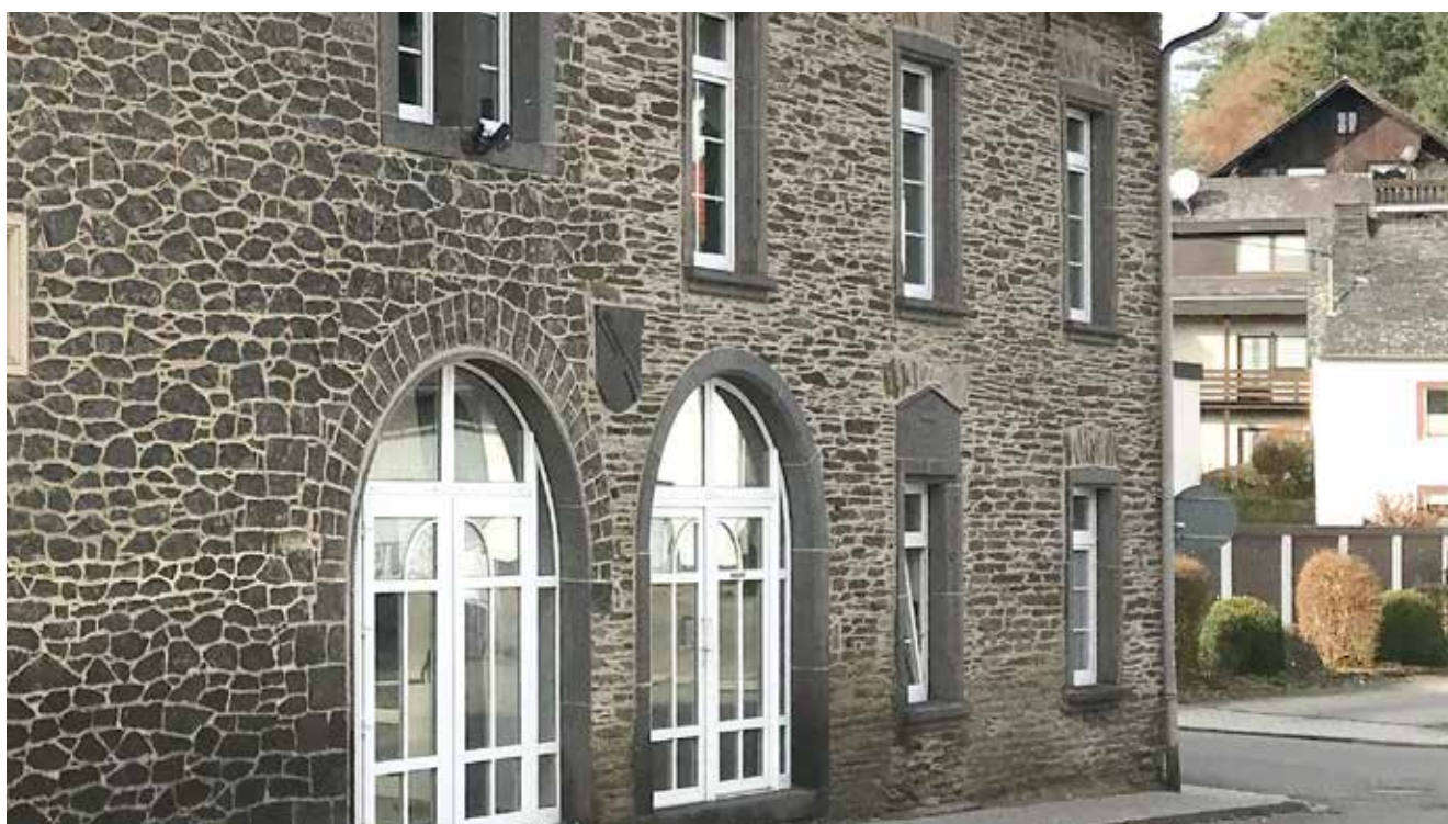
Positiv: auf Bestand abgestimmte Fensterelemente
