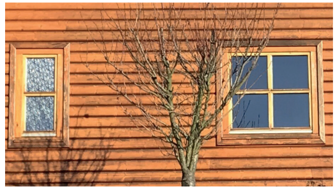
nicht bescheinigungsfähig: mit Blockhausprofil verkleidetes Wohnhaus
