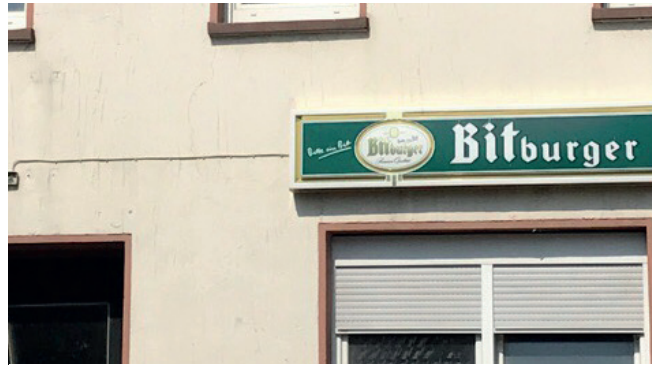
Negativ: Werbeanlagen mit offenliegenden Kabeln
