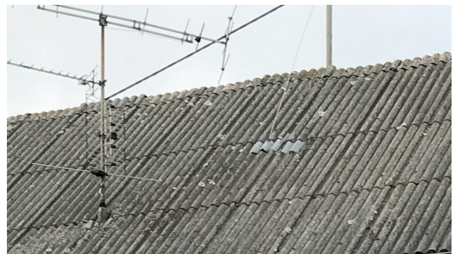
Negativ: Dacheindeckung aus Eternit
