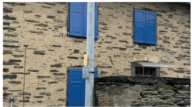
aufdringliche Farbgebung (Fensterrahmen, Klappläden)
