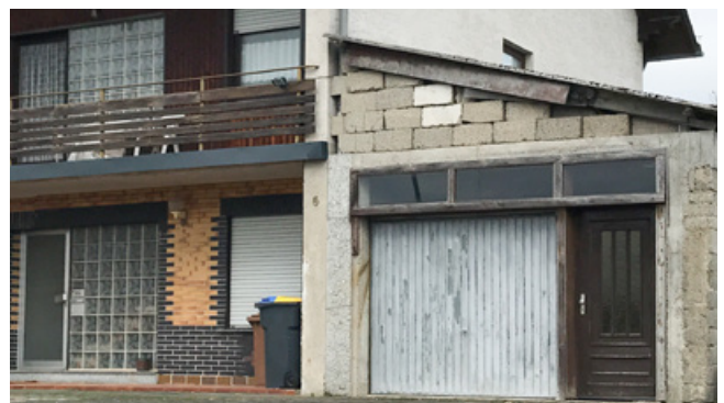
Negativ: angebauter Carport ohne Bezug zum Hauptgebäude
