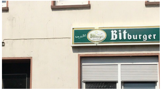
Negativ: Werbeanlagen mit offenliegenden Kabeln
