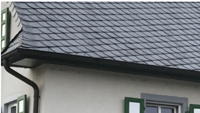
Negativ: überdimensionierter Dachüberstand (ortsuntypisch)
